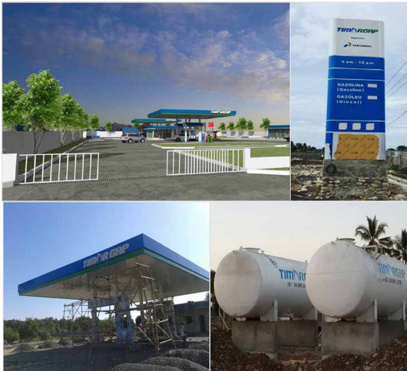
De cima para baixo (da esquerda para a direita): Desenho do posto de abastecimento de combustível; Progresso da construção do posto de abastecimento de combustível e depósitos de gasóleo no Suai
