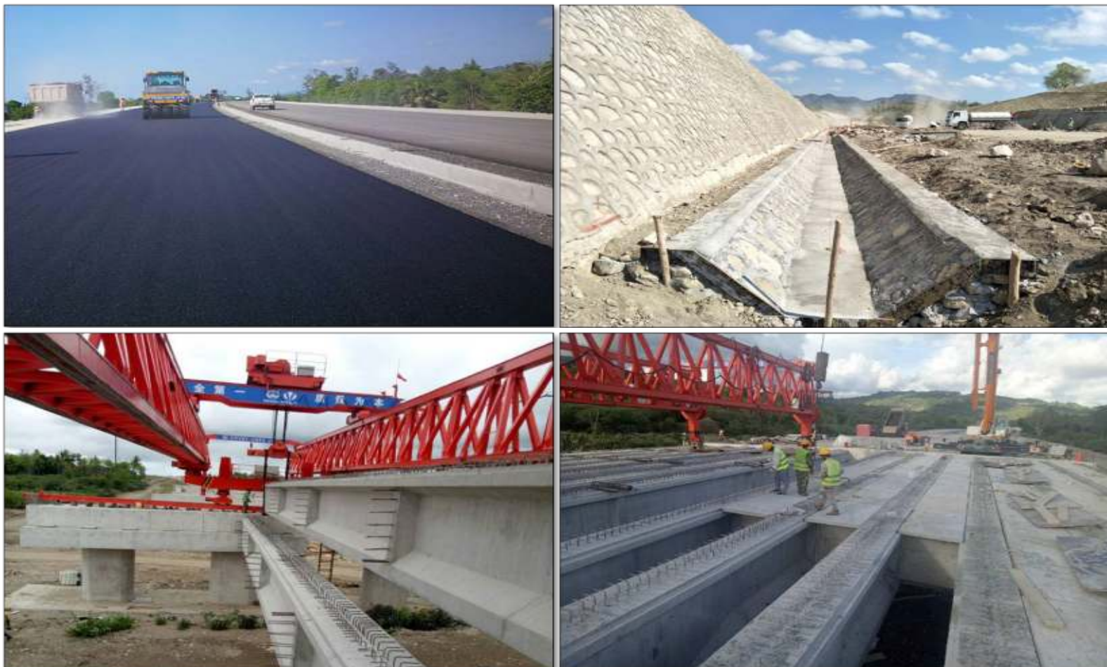
Figura 5-18: De cima para baixo, esquerda para a direita: Colocação de asfalto; Drenagem lateral; Colocação da viga da ponte de Karau-Ulun; Placa da ponte de Karau-Ulun
