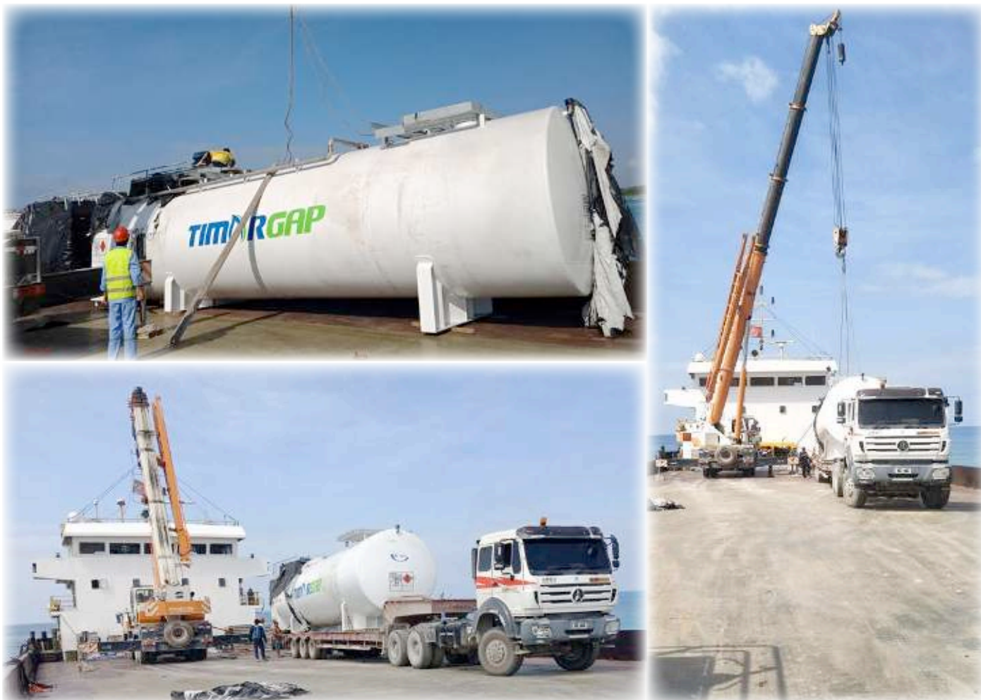
Figura 3-4: Atividades de desembarque dos tanques de armazenamento de combustível Jet A-1 no porto do Suai
