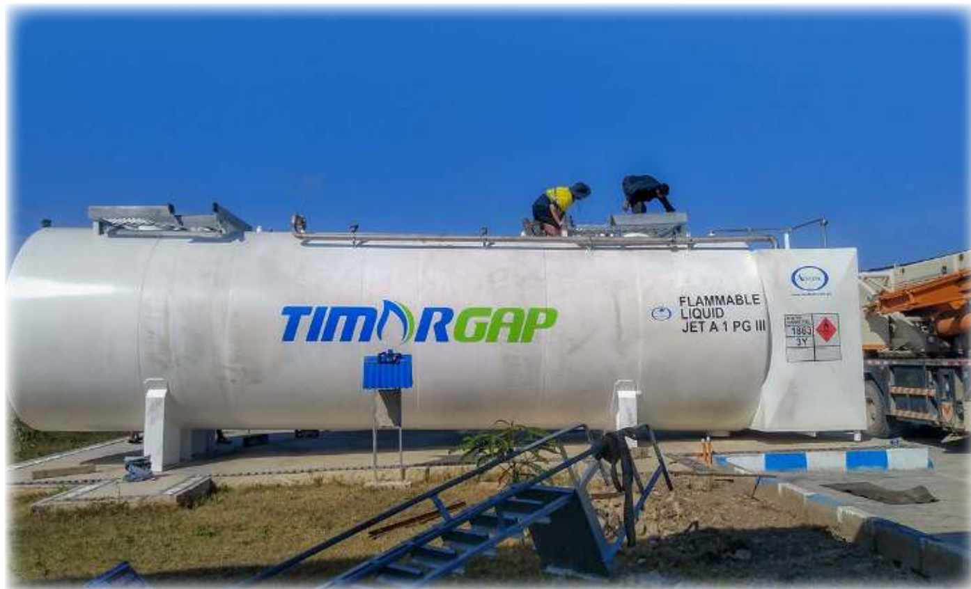
Figura 3-1: Instalação dos tanques de combustível jet A-1 da TIMOR GAP no Aeroporto do Suai
