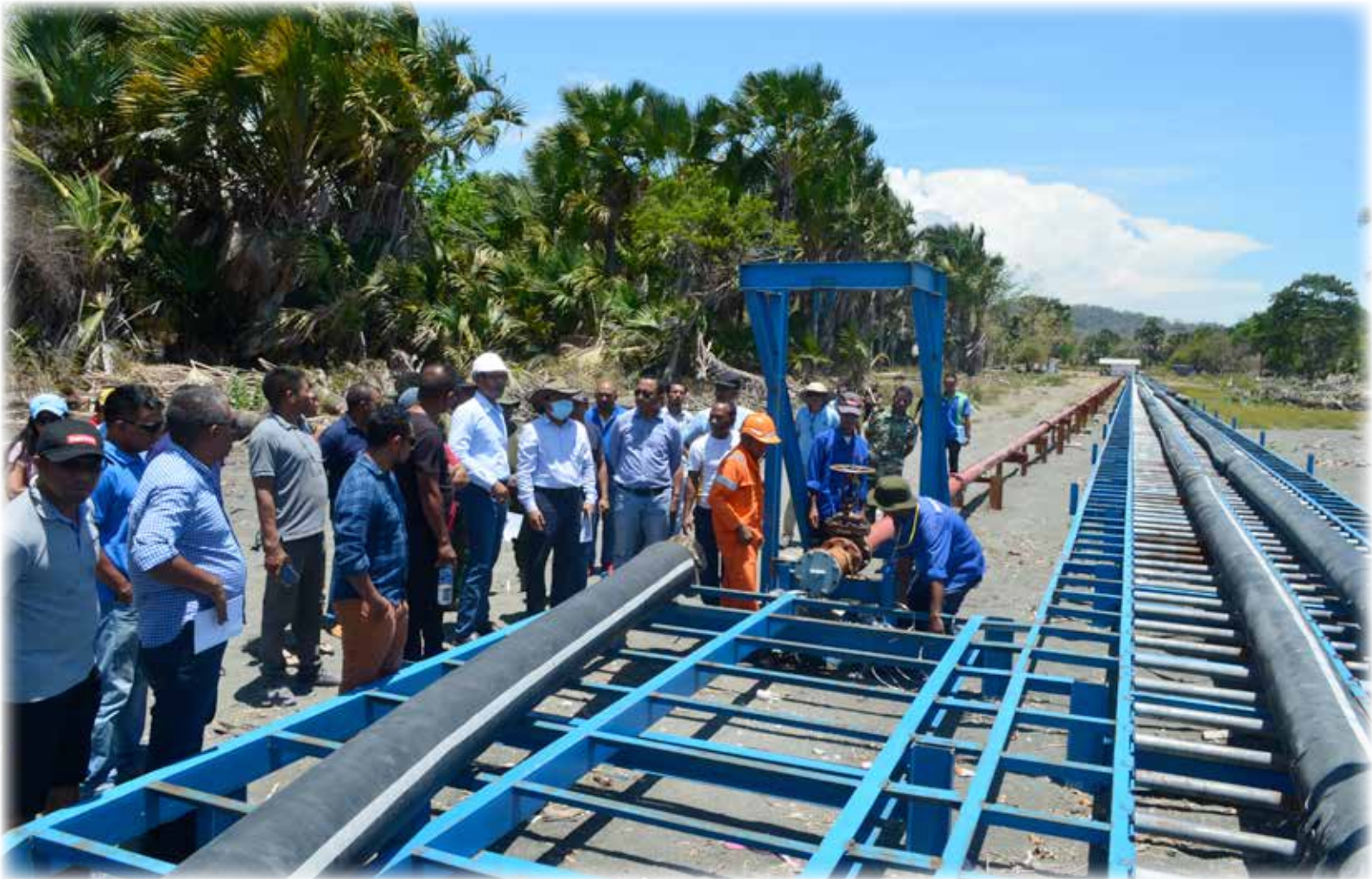
Figura 3-3: Visita de S. Exa. o Ministro do Petróleo e Minerais às instalações de descarga de combustível da SACOM em Betano
