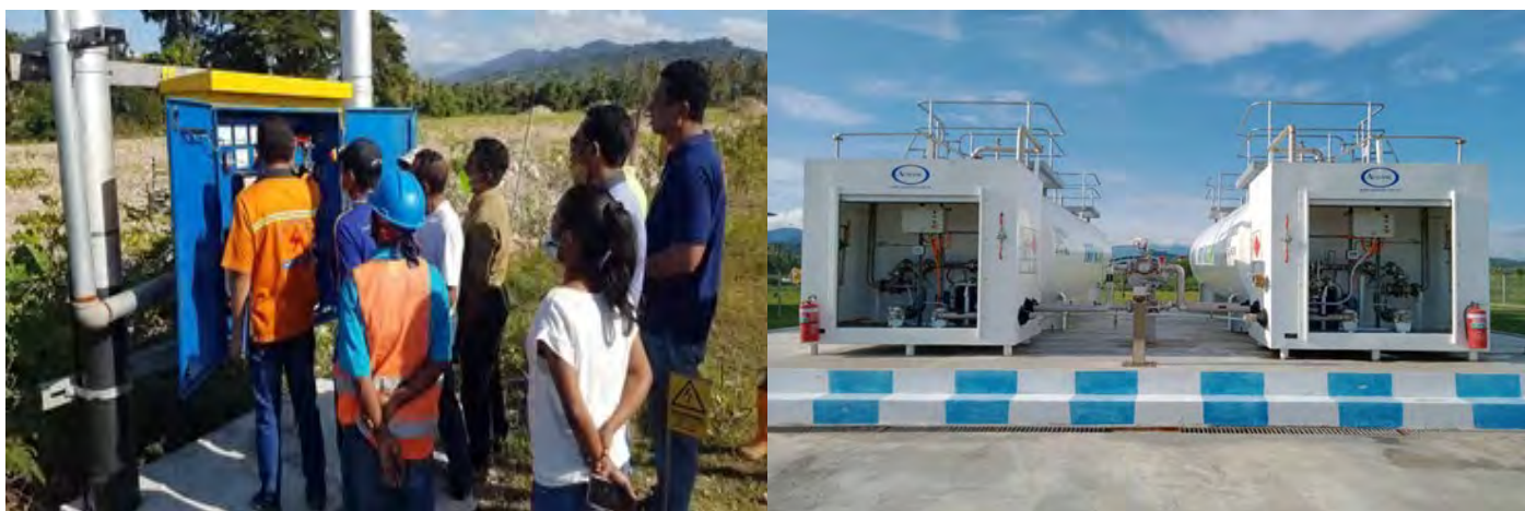
Figura 3-13: Inspeção da linha de baixa tensão (esquerda); Tanques de armazenamento de combustível (direita)
