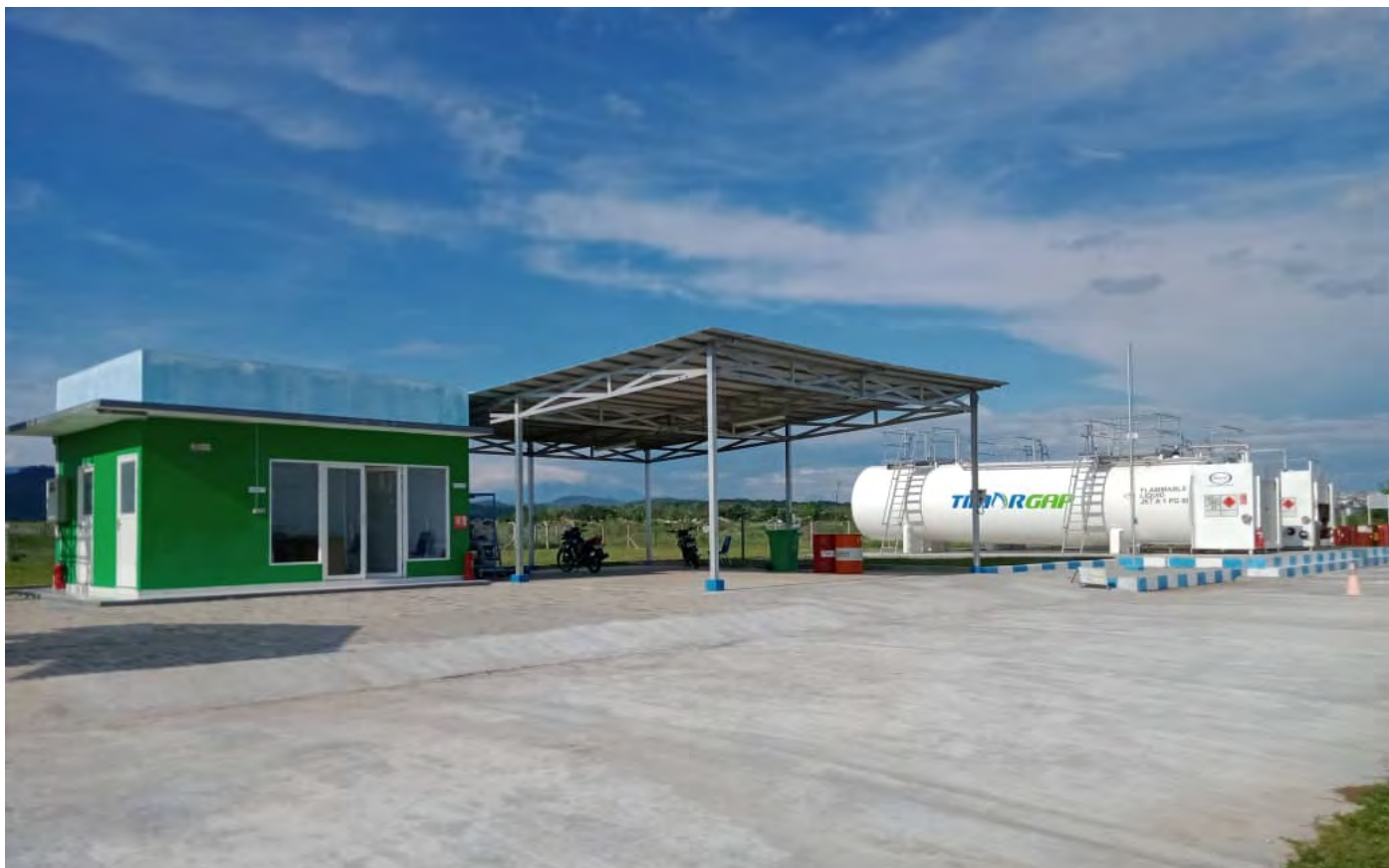
Figura 3-12: Instalação de Armazenamento de Combustível de Aviação da TIMOR GAP no Suai
