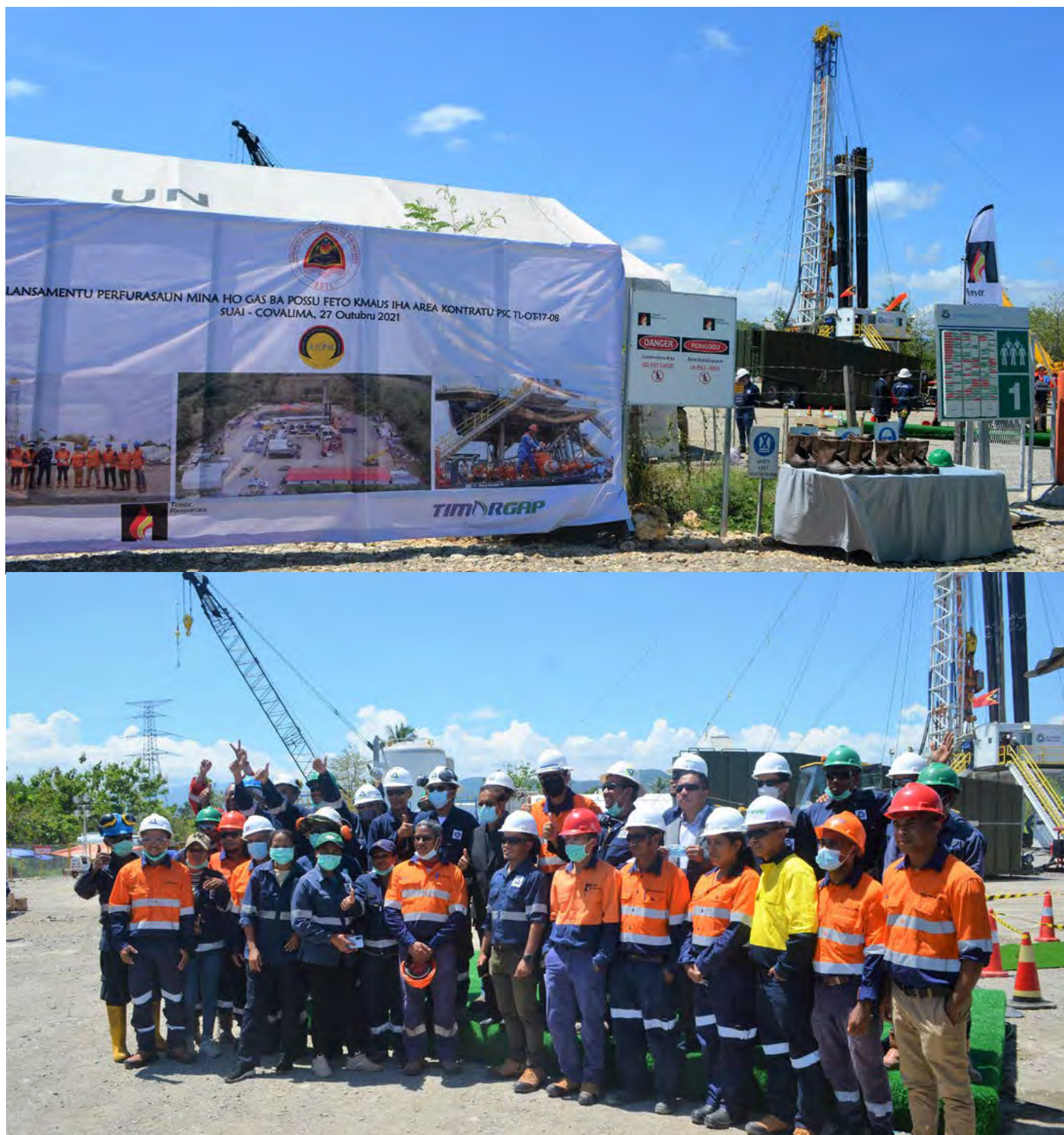
Figura 2-10: Lançamento da campanha de perfuração do poço de pesquisa de petróleo e gás, Feto Kmaus-1, no CPP TL-OT-17-08
